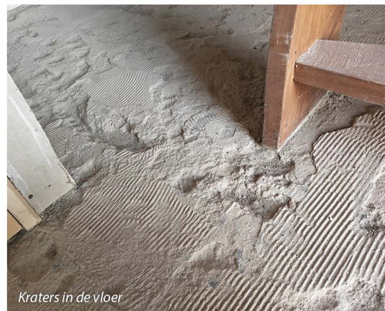
Sleuf en kraters in de vloer en lijmresten
